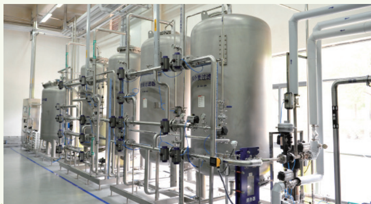
正大天晴水循環利用設備
