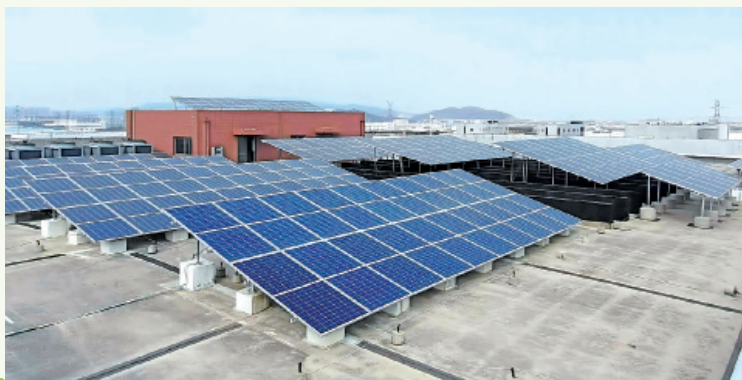
正大天晴光伏發電項目
